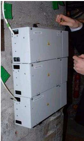
Exemple de point de mutualisation en pied d'immeuble
